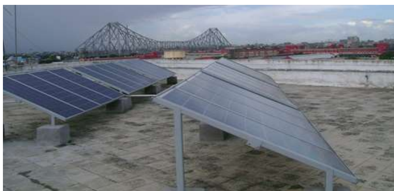
चित्र 9.2.1 हवड़ा नगरपालिका भवन पर छाया मुक्त इंस्टॉलेशन
