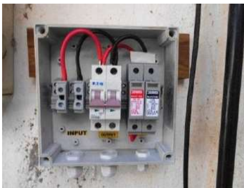
चित्र 8.3.6 AC डिस्ट्रीब्यूशन बॉक्स (AC आइसोलेशन के लिए AC MCB, सर्ज प्रोटेक्शन डिवाइस और इन्पुट साइड फ्यूज प्रोटेक्शन)
